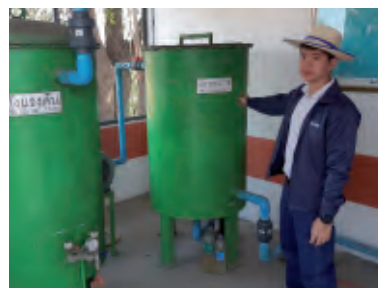
Klimaschutzprojekt in Thailand: Abwasserbehandlung mit Biogasverwertung bei Schweinefarmen
