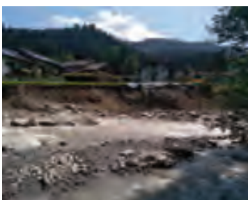
Meterhoher massiver Uferanriss mit temporärer Sicherung der Stromversorgung an der Kelchsauer Ache, Tirol
