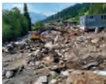
Verheerende Schäden an der Infrastruktur an der Kelchsauer Ache, Tirol
